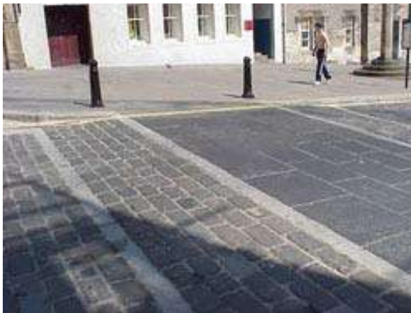
Εικόνα 2.3: Τοπική υπερύψωση (σαμαράκι) οδού από τούβλο στο Στέρλινγκ της Σκωτίας (Πηγή: Ciekoł, 2001)
