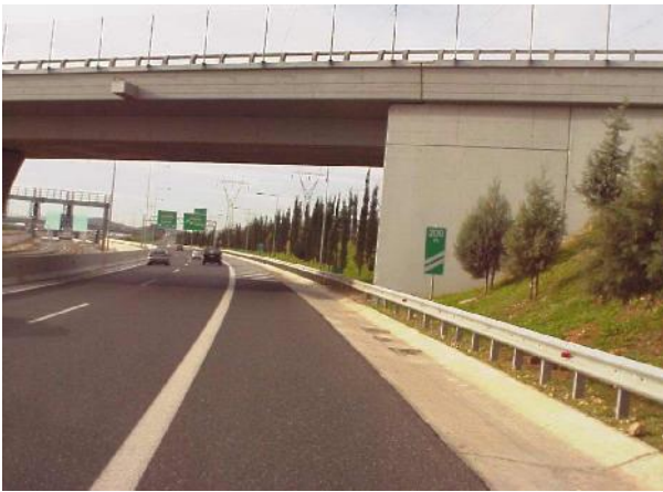
Φωτογραφία 7. Ακμή βάθρου γέφυρας σε επαφή με το πλευρικό στηθαίο ασφαλείας Picture 7. Bridge pier in contact with the side guard rails
