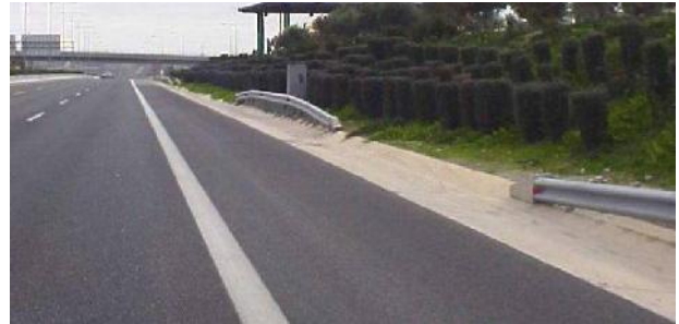
Φωτογραφία 3. Μικρού μήκους διακοπή του πλευρικού στηθαίου ασφαλείας Picture 3. Short break in guard rails
