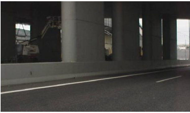
Φωτογραφία 4. Βάθρο γέφυρας σε επαφή με το πλευρικό στηθαίο ασφαλείας Picture 4. Bridge pier in contact with concrete safety barrier
